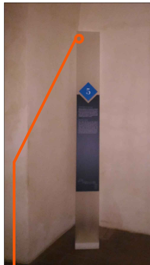
ART 12.05 - Sostituzione palina informativa con ancoraggio al muro mediante profilo Halfen e tasselli chimici.
