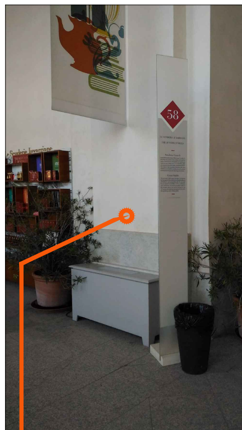
ART 12.31 - Sostituzione palina informativa con ancoraggio al muro mediante profilo Halfen e tasselli chimici
