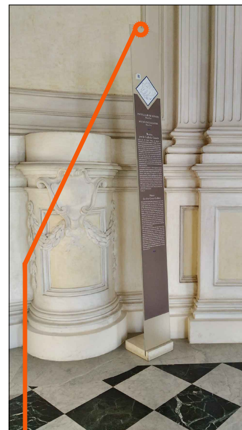
ART 12.21 - Sostituzione palina informativa con ancoraggio al muro mediante profilo Halfen e tasselli chimici
