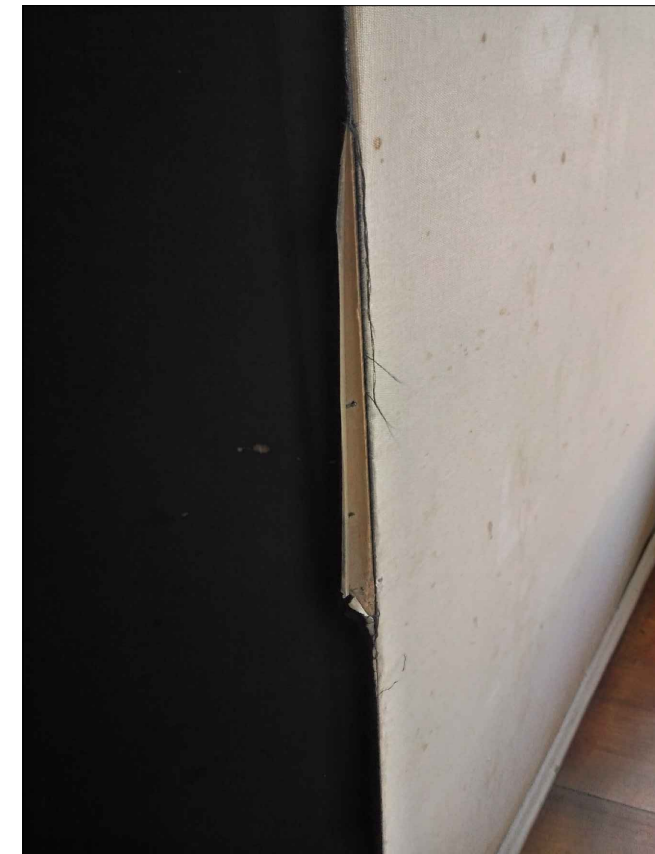
DETTAGLIO AMMALORAMENTO ANGOLO 16
